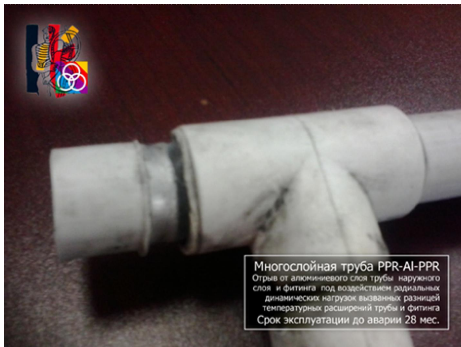
Рис.4 Отрыв полипропиленового фитинга от трубы PPR-AL-PP. Срок эксплуатации до аварии 28 мес.
