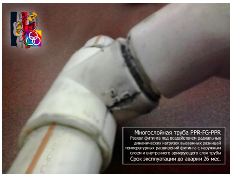
Рис.5 Раскалывание полипропиленового фитинга от трубы PPR-FG-PP. Срок эксплуатации до аварии 26 мес.
